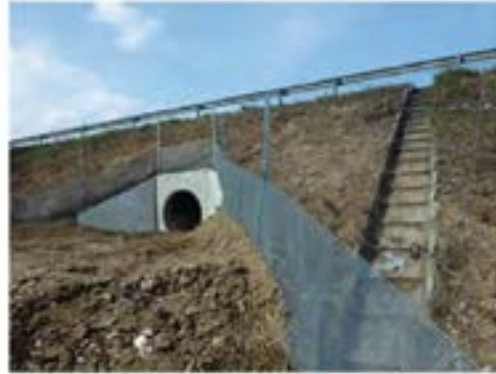
Passage petite faune de Velaux Autoroute A7 : vue sur le dispositif finalisé côté plateforme de poussage. Source : Vinci Autoroutes/Réseau ASF.
