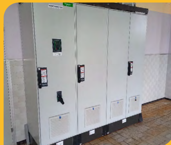
Variateurs de fréquence des pompes de refoulement
