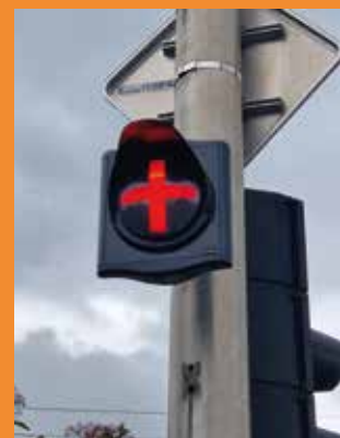
Croix lumineuses rouges aux carrefours à feu de l'avenue Jean Jaurès
