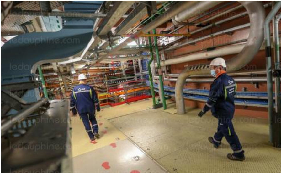
En 2024, les opérations de démontage ont pris de l'avance sur le planning des travaux. Photo archives Le DL/Michel Thomas
