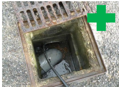
Avaloir d'eau pluviale avec bac de décantation
