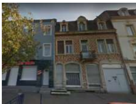
Remplacement d'une vitrine par une porte de garage, suppression d'encadrements, menuiseries inadaptées, rue de la Gare
