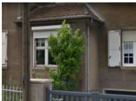
Caisson extérieur de volets roulants, rue Joffre
