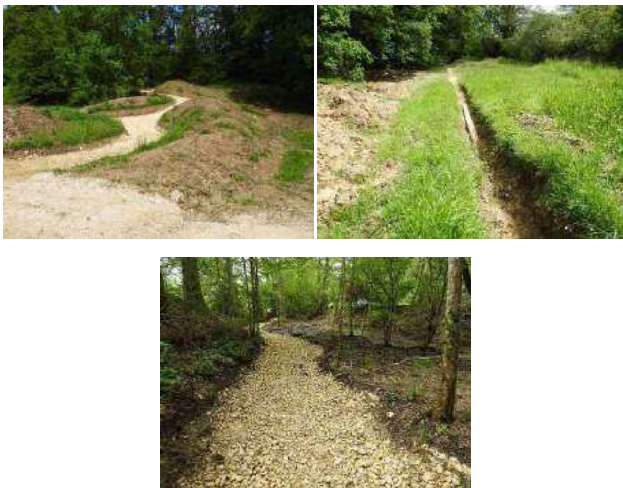
Figure 44 : Remblais, canalisations et voiries créées en zone humide à prendre en considération
