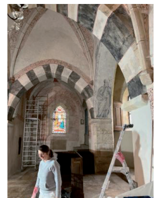
Les travaux sur les peintures murales de l'église et la restauratrice Alice Breuillard
