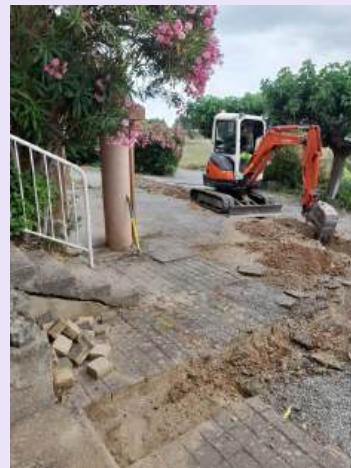
Gîte communal route d'Artix : raccordement de la fibre au gîte, tranchée réalisée sur terrain privé de la commune.
