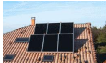
↑ Interdit : Panneaux en surimposition non parallèlement à la toiture
