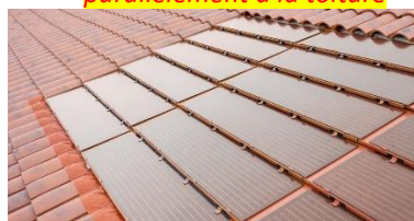
Image : Rémi Portier, Piguët SAS ↑ Autorisé : Panneaux intégrés, teinte avoisinante à celle des tuiles
