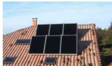
↑ Interdit : Panneaux en surimposition non parallèlement à la toiture
