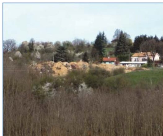
Terrassements très visibles en crête de vallon
