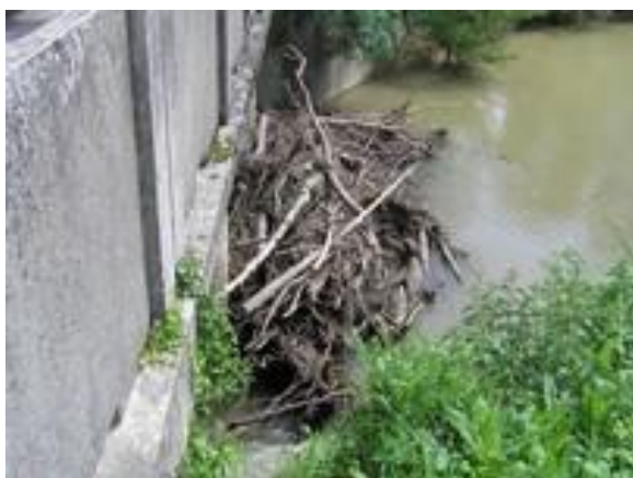
Accumulation de végétation sur une pile de pont ©DDT32
