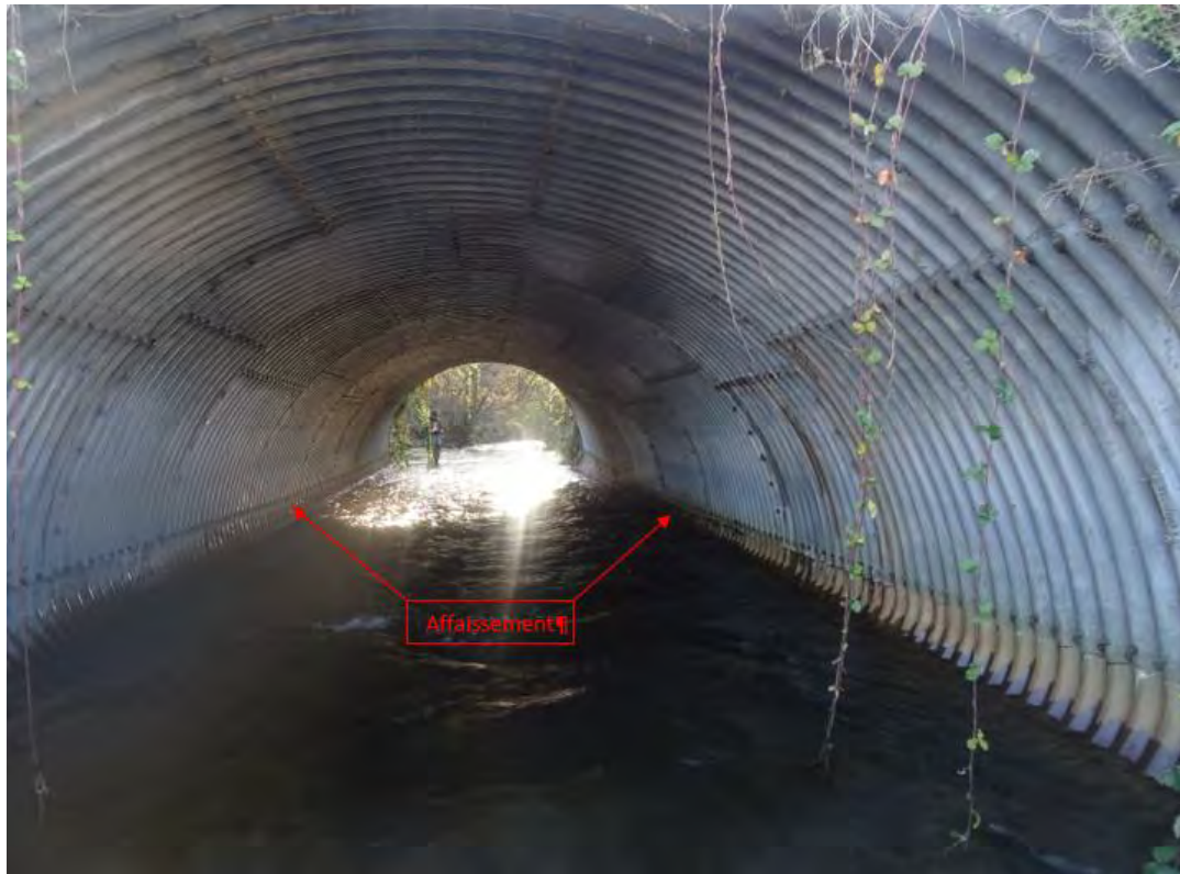
Figure 5 : Affaissement repéré sur l'ouvrage BOTO_19
