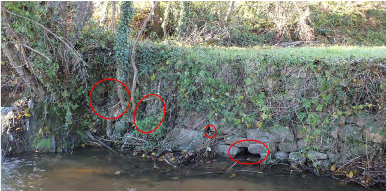
Figure 4 : Descellements localisés sur un mur de soutènement avoisinant l'ouvrage SB70 et remettant en cause sa stabilité
