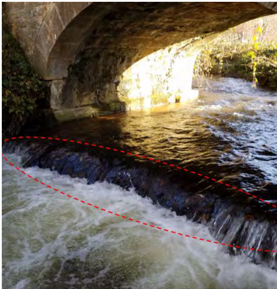
Figure 6 : Affouillement profond sur la totalité du linéaire du seuil observé sur l'ouvrage SB124
