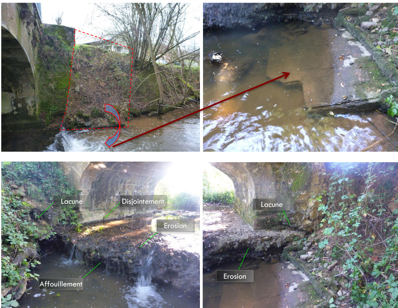
Illustration 6: Effondrement du mur d'ancrage aval (haut) et désordres au niveau du radier (bas). Source : CESAME 2019
