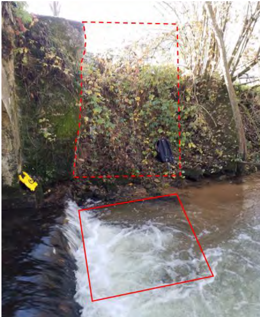
Figure 7 : Instabilité du mur de soutènement avoisinant l'ouvrage SB124
