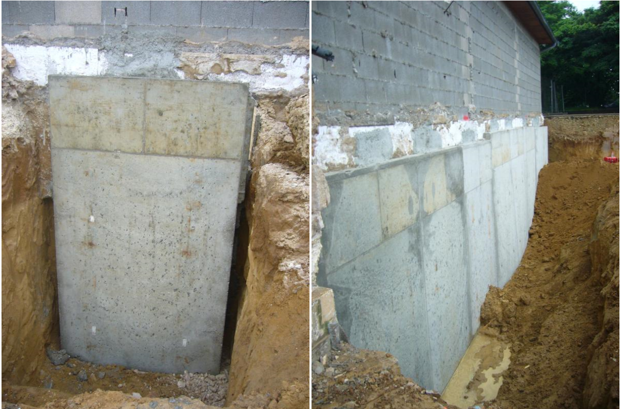
Illustration 14 : Illustration d'une reprise en sous-œuvre d'une fondation par passes successives. Source : B-Ingénierie
