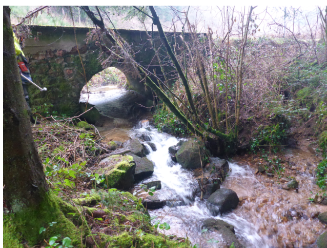
Illustration 5 : Photos de l'ouvrage à différents débits (haut) et morphologie accidentée en aval de l'ouvrage. Source : CESAME
