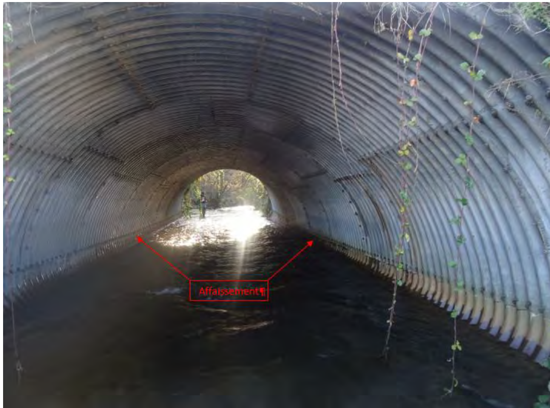
Figure 5 : Affaissement repéré sur l'ouvrage BOTO_19
