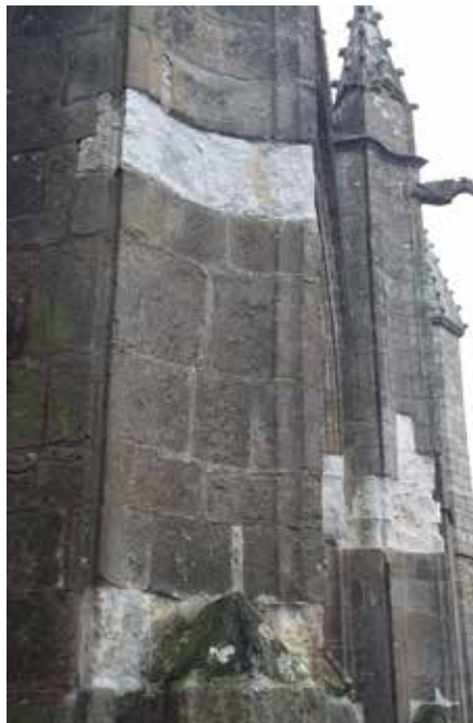
Façade nord - tuffeaux dégradés.
