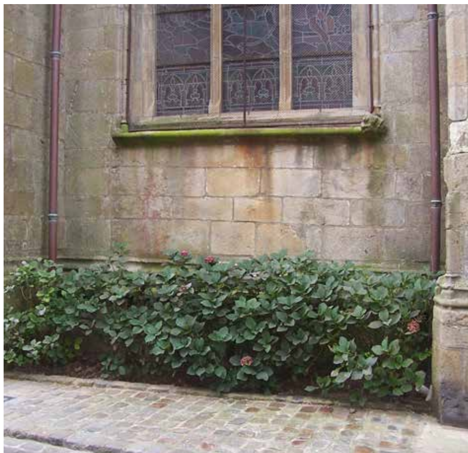
Façade nord - remontées d'humidité, joints ciment
