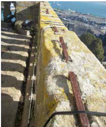
Belvédère - dégradation des agrafes de la balustrade.
