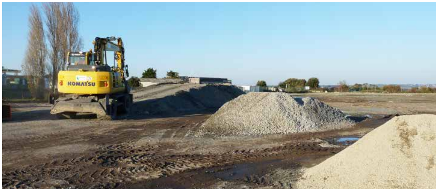
La ville a procédé au nettoyage de son terrain de 10 000 m 2 avant sa vente à Cap Atlantique.
