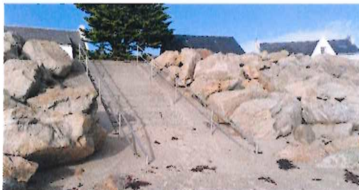
Ensemblement du pied de l'enrochement entraînant l'élévation du niveau de la plage (escalier ensablé)
