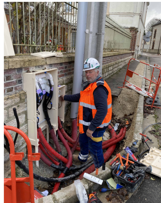
Câblage des coffrets d'électricité pour les travaux d'enfouissement de réseaux de la rue du Jeu de Boules
