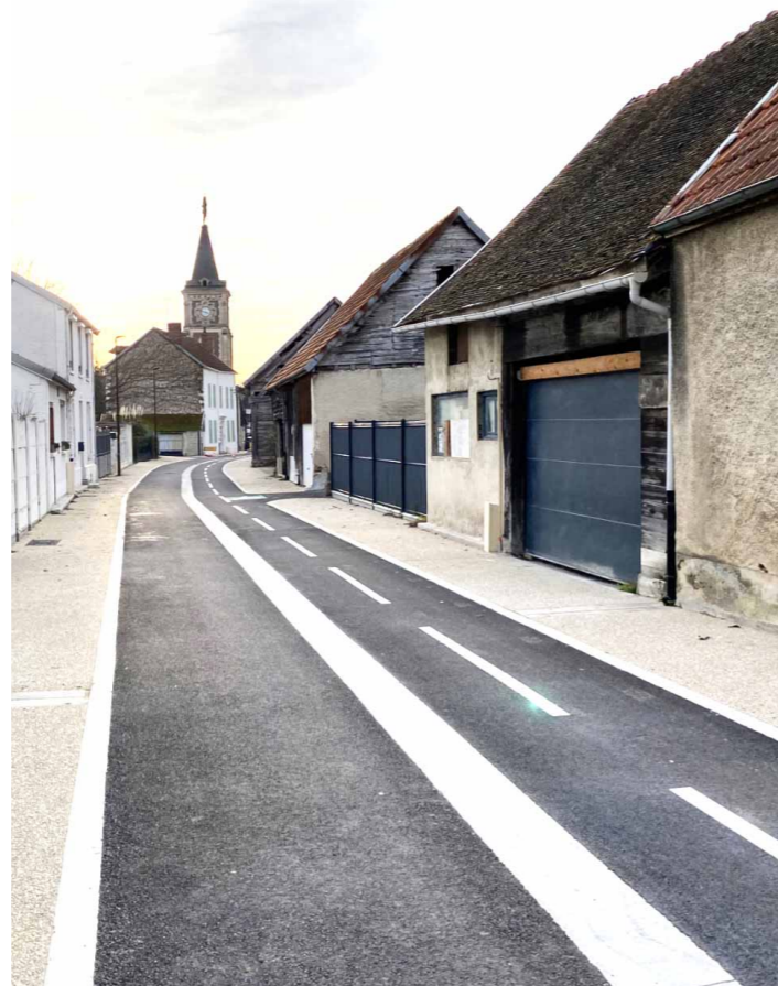
Rue Chevalot terminée - réseaux neufs souterrains, enfouissement des réseaux aériens et refonte complète de la voirie
