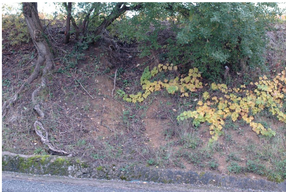
Figure 10 : érosion dans le talus de la RD 68
