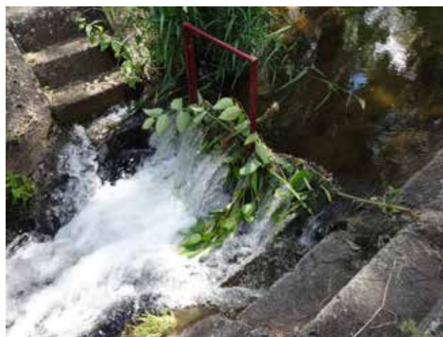
Écoulement obstrué par les déchets verts
