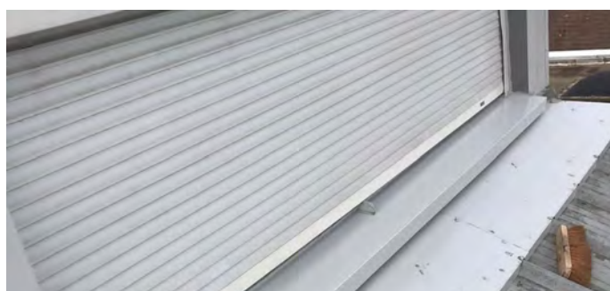
Étanchéité de la salle des fêtes
