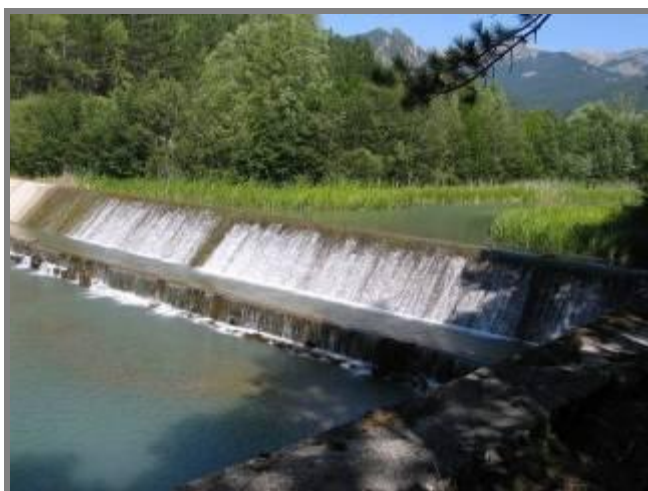
Seuil infranchissable à Castellane
