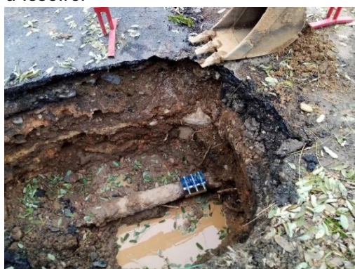
Canalisation Pont de la Couze datant de 1956.
