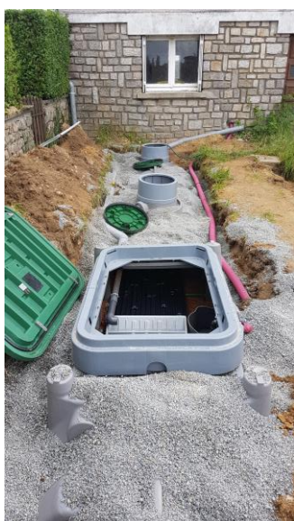
Assainissement non collectif composé d'une filière compacte
