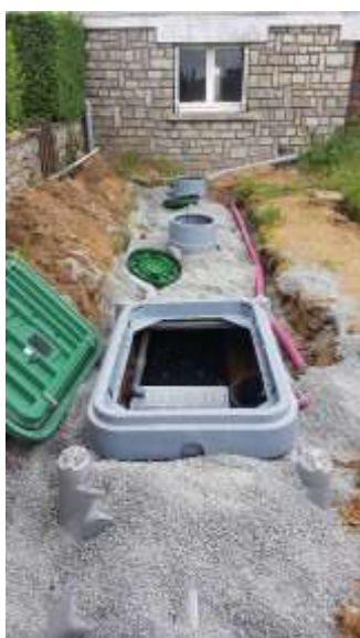
Assainissement non collectif composé d'une filière compacte
