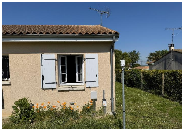
Figure 1 Instrumentation type MACH : une station météo, un fissuromètre, une centrale d'acquisition des capteurs de teneur en eau enterrés
