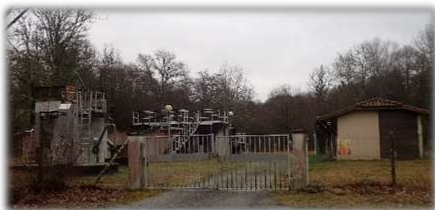
Photo 35 : Station d'Épuration de Saint-Pardoux
