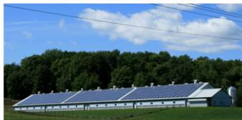
Photovoltaïque en toiture
