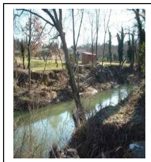
Érosions de berges et habitations inondées entre Brignon et Moussac (photo BCEOM)
