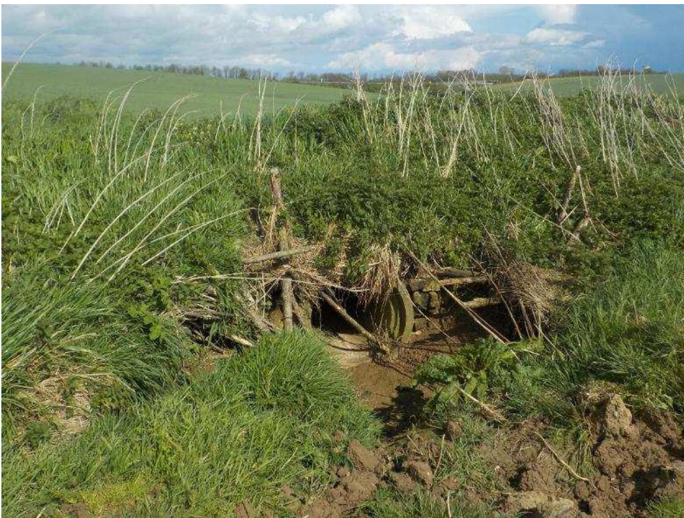
Photo fascine 2 : fascine détruite à l'amont de l'ouvrage sous le chemin rural
