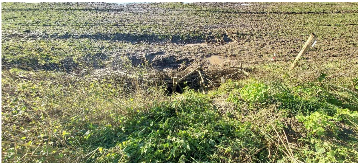
Figure 67 : Fascine en cours de réfection lors de la visite de décembre 2024
