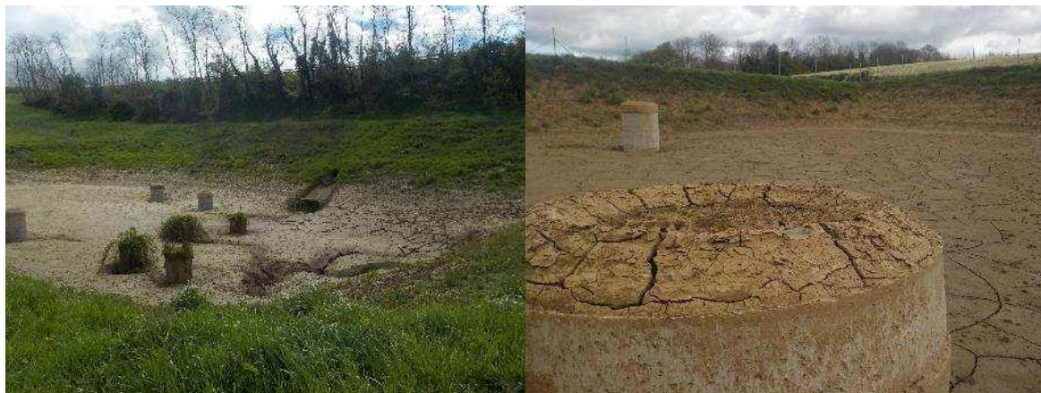
Photos 4 : Dépôts de sédiments dans le bassin d'infiltration et sur les puits d'infiltration
