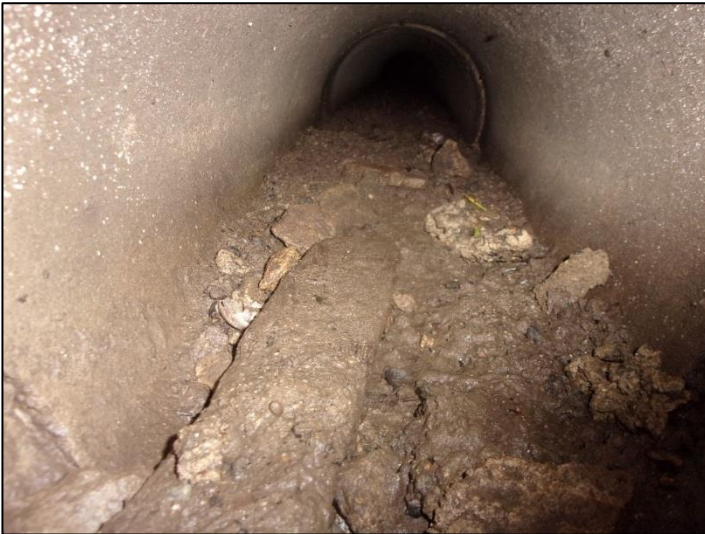
Photo 2 : Vue d'un réseau à curer – Rue Joseph le Pévédic (Ø300)
