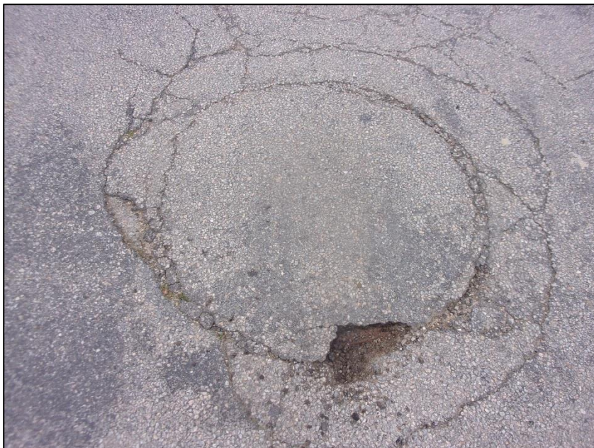
Photo 4 : Vue d'un tampon sous enrobé – Rue Joseph le Pévédic
