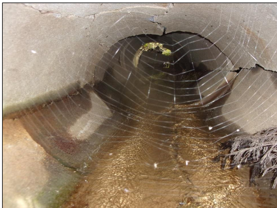
Photo 6 : Réseau Ø300 fissuré - Rue du Commandant Théodore Guillo
