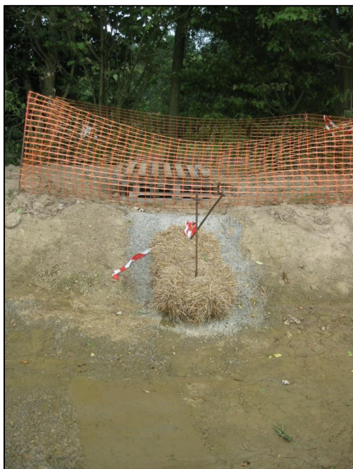
Photo 8 : Emplacement du filtre à particules fines (botte de paille) pendant la phase des travaux au niveau du bassin d'orage
