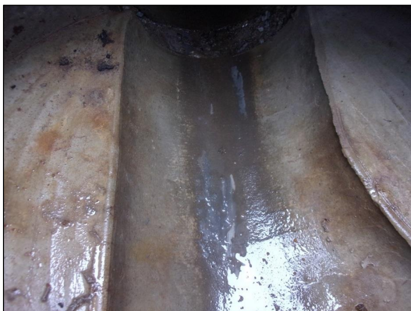
Photo 5 : Vue d'un rejet d'eaux vannes
