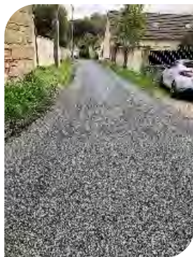
Gravillonnage de la rue du cul-de-sac et une partie de la rue du jeu d'arc par la société Perez.
