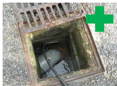
Avaloir d'eau pluviale avec bac de décantation
