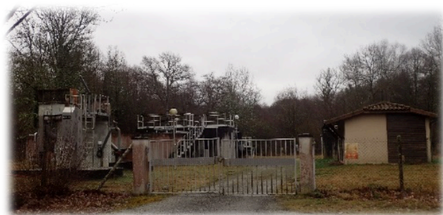
Photo 52 : Station d'Épuration de Saint-Pardoux
