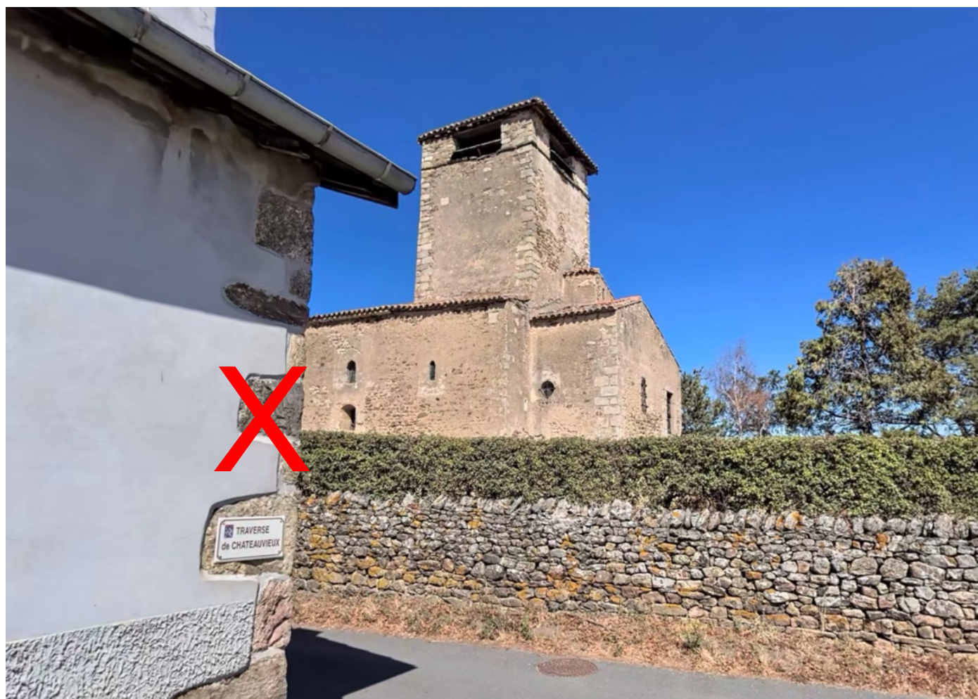
Pierre mise à nu au niveau de la chaîne d'angle, enduit irrégulier faussement pittoresque. (Châteauneuf).
