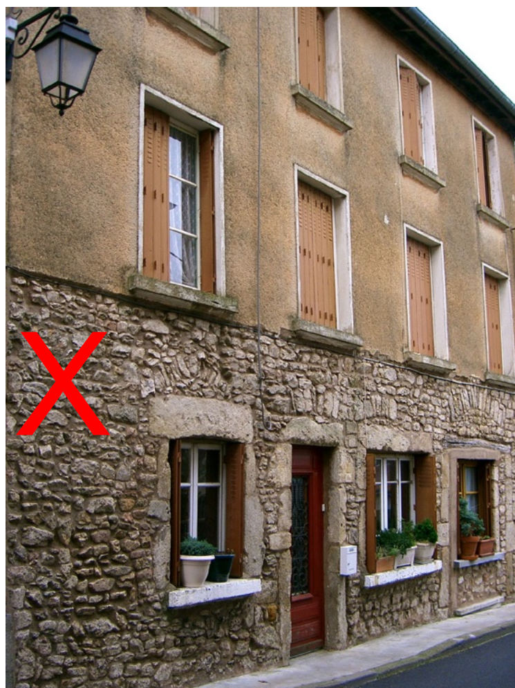
Pierre mise à nu en rez-de-chaussée d'un immeuble (Rue Centrale)
