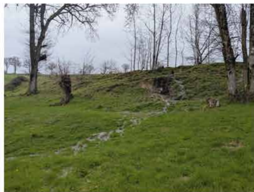
Chaussée déstructurée par les ragondins
