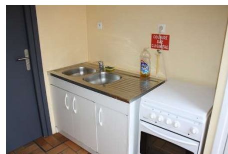
Espace vaisselle et réchauffage 3 feux
