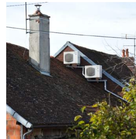
Mauvais exemple de pompes à chaleur installées en façade pignon vues de l'espace public, photo ALAP.
