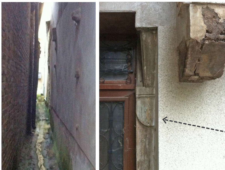
Passage insalubre à transformer.
