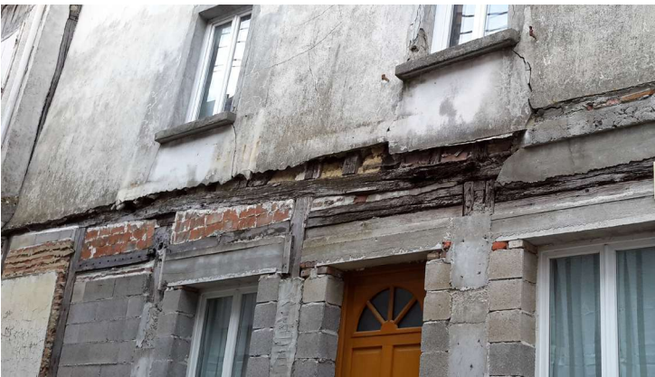
Le remplacement d'une partie du pan de bois par de la maçonnerie, et l'enduit ciment sur la partie haute mettent en péril toute la construction.
