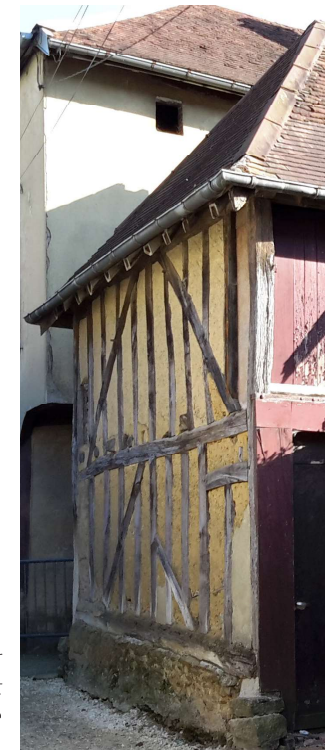
Pan de bois apparent à réparer ponctuellement (charpente et remplissage en torchis); enduit de protection du torchis à refaire.
