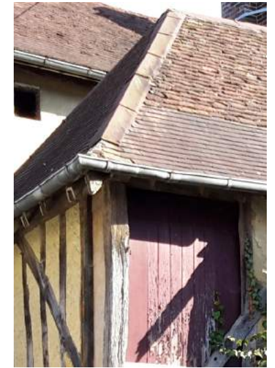
La couverture en tuiles plates ancienne a été partiellement réparée avec des tuiles de fabrication récente bien moins épaisses, faisant perdre à la toiture une partie de son cachet.
