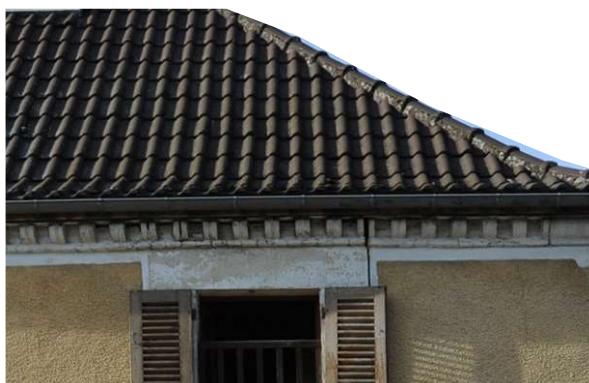
Tuiles pannes en «S» brunes inadaptées au bâti ervytain .
