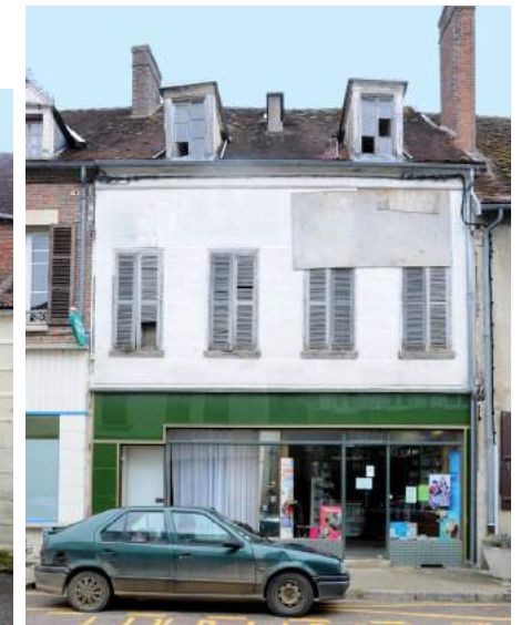
A côté de la porte Saint-Nicolas Monument historique, l'immeuble en mauvais état qui abrite la pharmacie.
