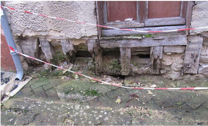
L'absence (ou l'enfouissement) du soubassement maçonné du pan de bois soumet la charpente aux dégradations dues à l'humidité du sol et aux rejaillissements d'eau de pluie.
