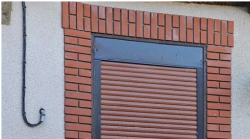
Habillage en placage, câbles sur l'enduit.
