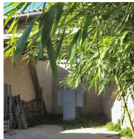
Exemple de pompe à chaleur AIR-EAU forte puissance (chauffage + eau chaude) carénée, installée sous appentis, photo ALAP.
