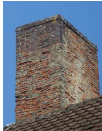
Cheminée en brique : attention à maintenir les souches de cheminée en bon état, les maçonneries dégradées constituent des entrées d'humidité dommageables pour la structure du bâtiment, notamment lorsqu'elle est en pan de bois.
