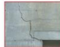
Enduit ciment sur une maçonnerie ancienne : fissurations
