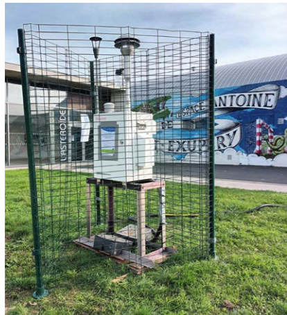
Capteur ATMO installé au Complexe Saint-Exupéry
