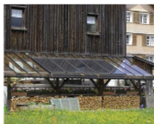
Les capteurs sont intégrés à la couverture d'une remise à bois. Maison individuelle (Vorarlberg, Autriche) © PNR du Vexin français
