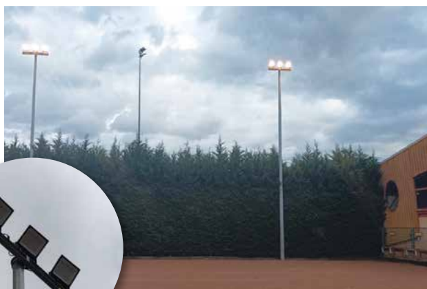
Eclairage LED boulodrome extérieur
