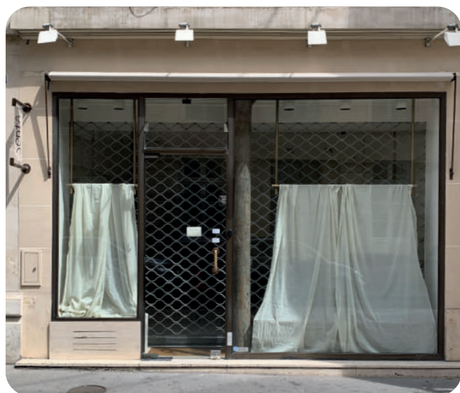
Volet roulant placé en intérieur
