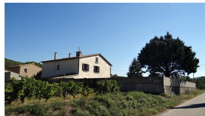
Mur de clôture non enduit peu esthétique
