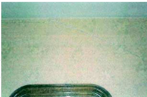
Fissuration intérieure, tapisserie déchirée - Maison André.
