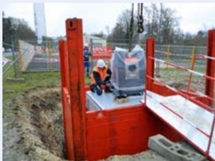
Colonne enterrée sur le parking de l'Avenue Guy Ignolin
