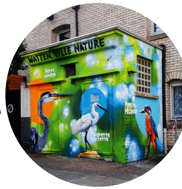
JUILLET UN TRANSFORMATEUR HTA/BT RELOOKE EN OEUVRE D'ART À WATTEN
