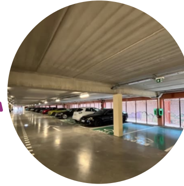
20 MARS MISE EN SERVICE DE 28 BORNES IRVE AU PÔLE D'ÉCHANGE DE LA GARE D'HAZEBROUCK
