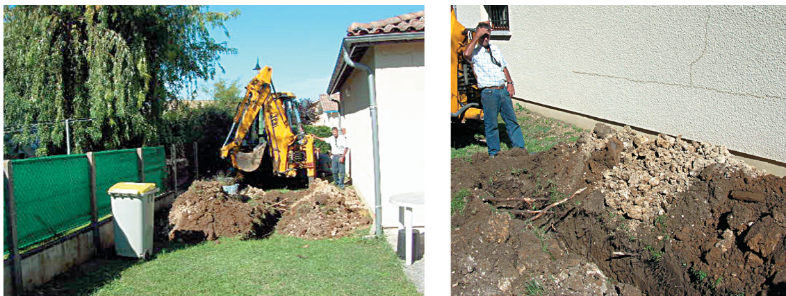
Figure 5 Exemple de pathologie (fissures) liées à la présence de racines sous la construction (vue d'ensemble à gauche et vue des racines et des fissures à droite) (Source Socabat)
