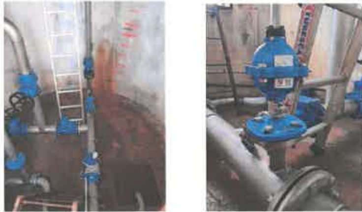
Chambre de Vannes d'Ouvans
